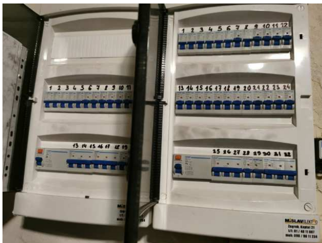
Slika 1. – Postojeći razdjelnik u sakristiji.
